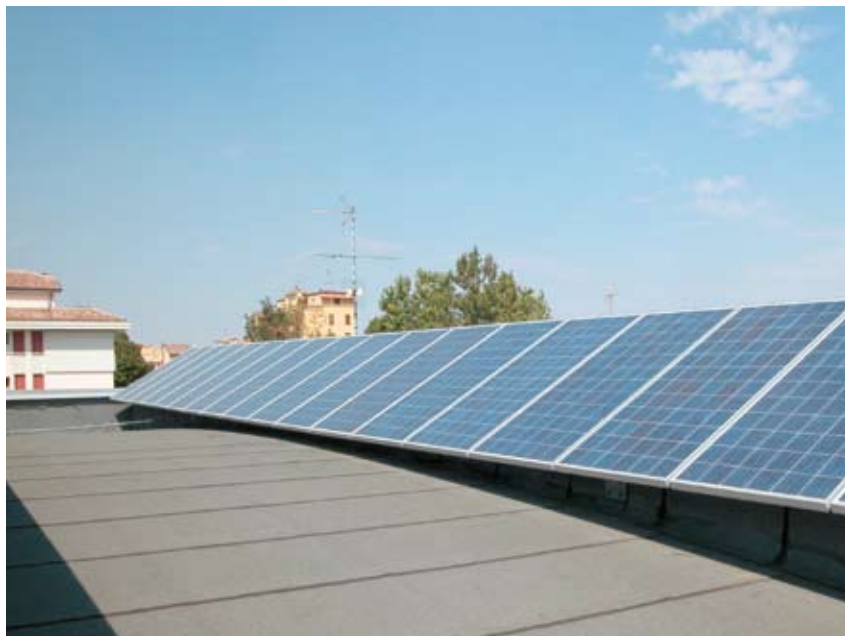
Pannelli fotovoltaici sul palazzetto sportivo di via Muzzinello
